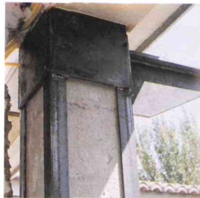
Encamisado con olguras, sin posibilidad de transferencia de cargas al soporte de hormigón que abraza.
