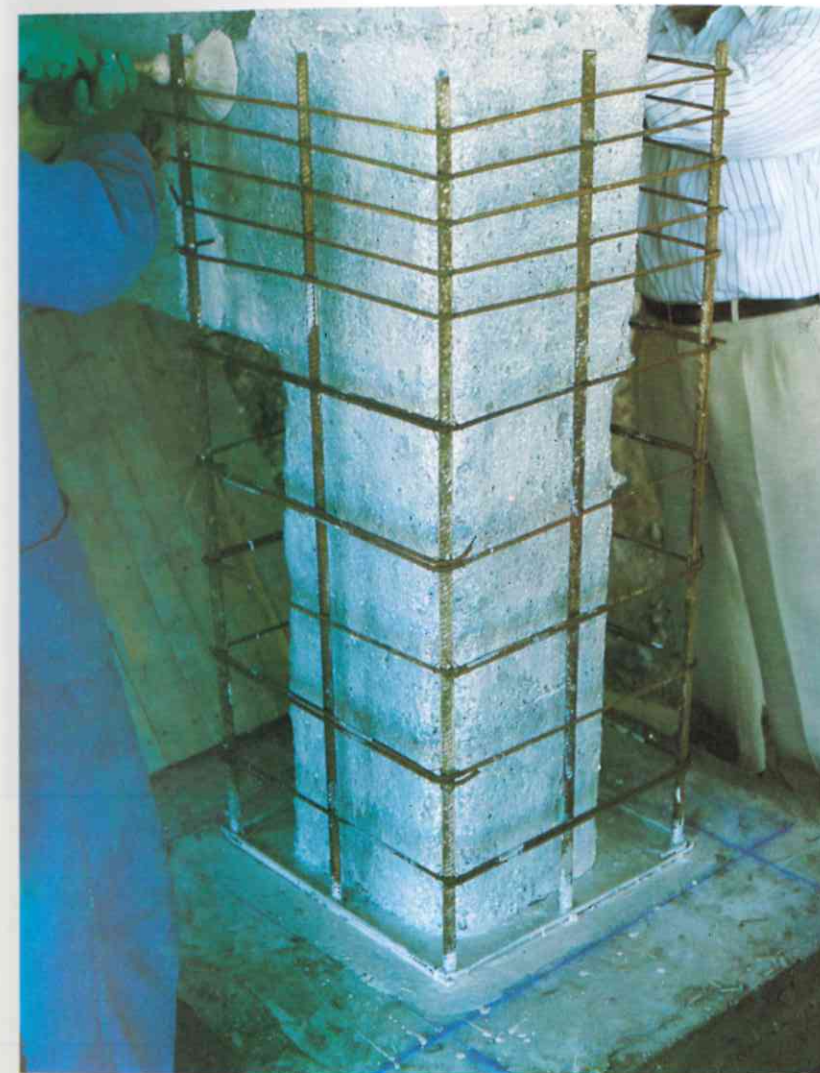
Colocación de estribos cerrados, para retracción, evitación pandeo armaduras longitudinales, y eventualmente, para absorción de cortantes transversales.
