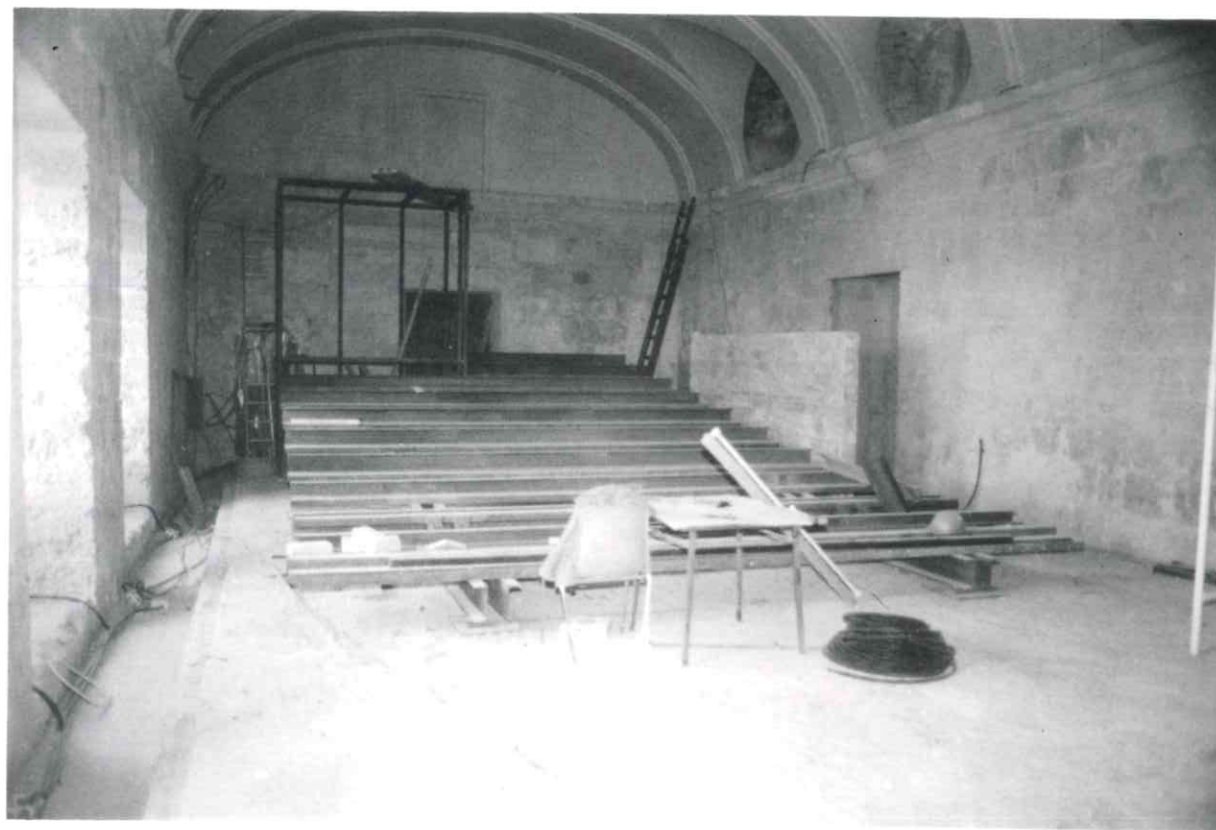
Estructura graderio Salón de Actos. Al fondo izquierda, estructura de la cabina de traducción.
