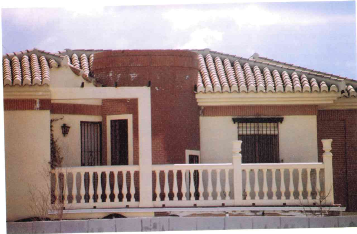
También algunos edificios nuevos presentan problemas de humedad a causa de las lluvias.
