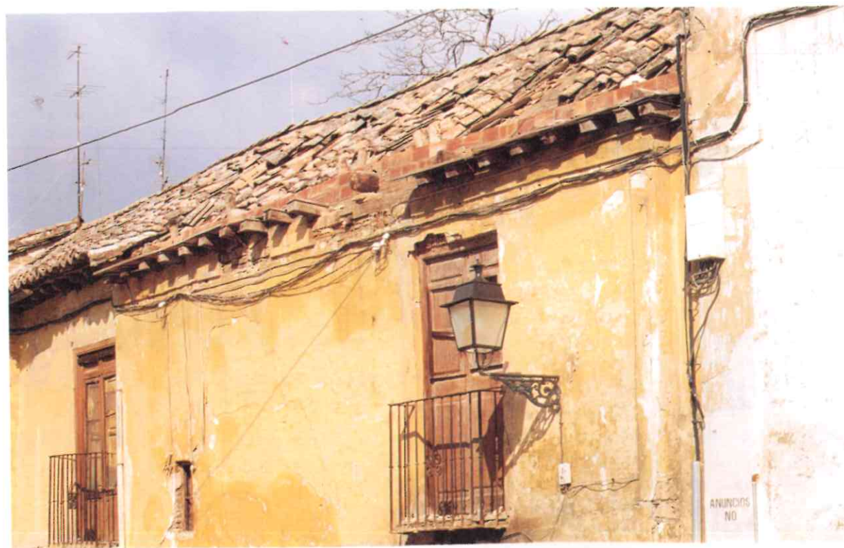
Las casas antiguas son las que más sufren las consecuencias de las lluvias prolongadas.
