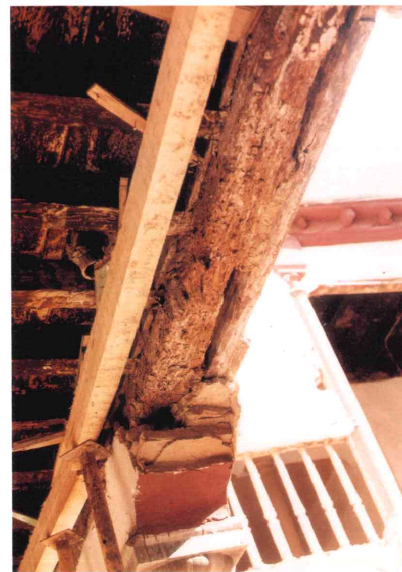
Foto 3. Estado previo. Estado de conservación de vigería.
