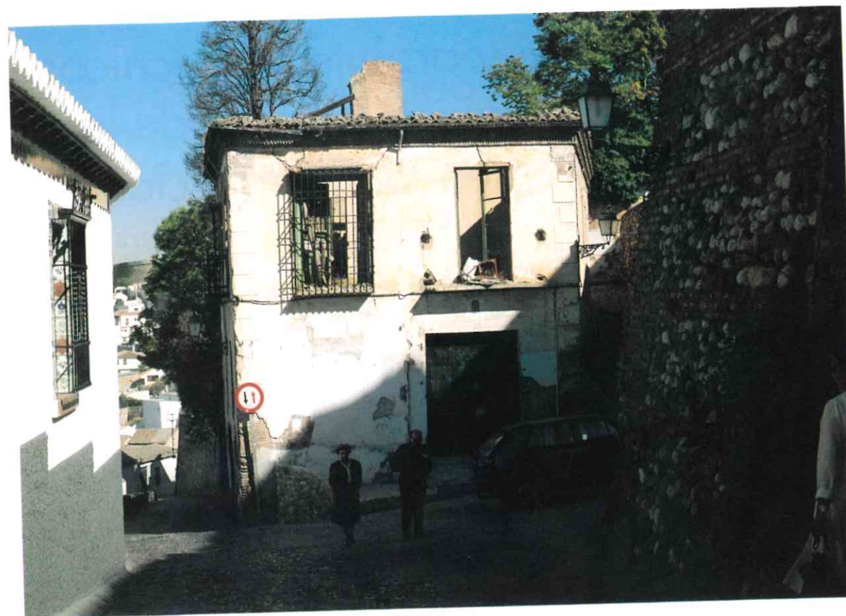
Una de las muchas viviendas en estado ruinoso, en el Albaicín.
