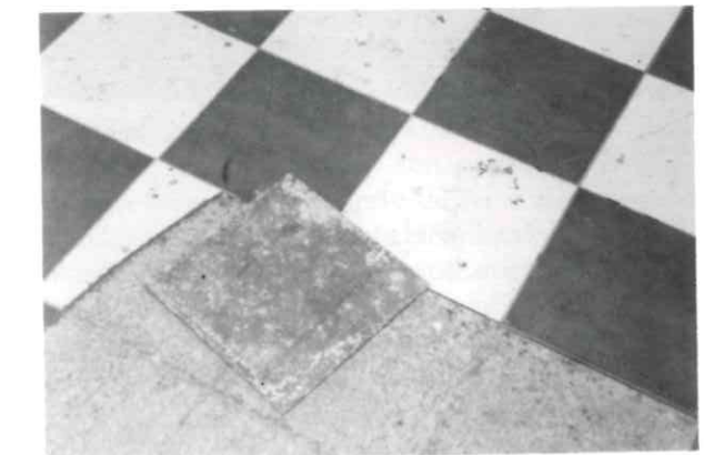
Falta de adherencia.
