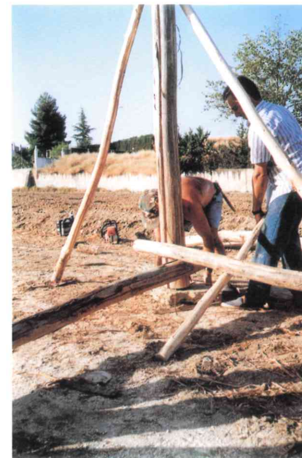
La cimentación pétrea del secadero de palos se coloca una vez que se ha terminado la estructura del mismo. Podemos observar cómo un operario levanta la estructura haciendo palanca para introducir el cimient.
