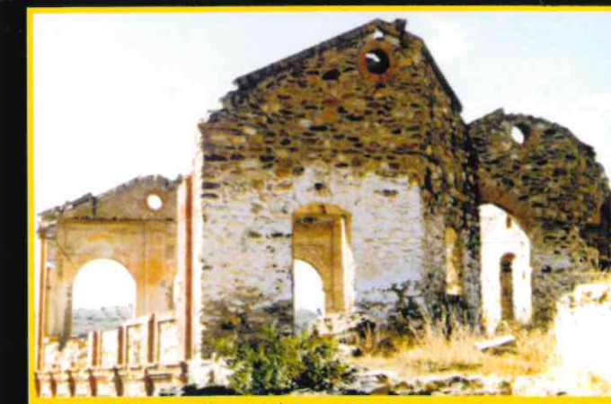
[Fig. 5] El expolio dejó la cubierta en este estado
