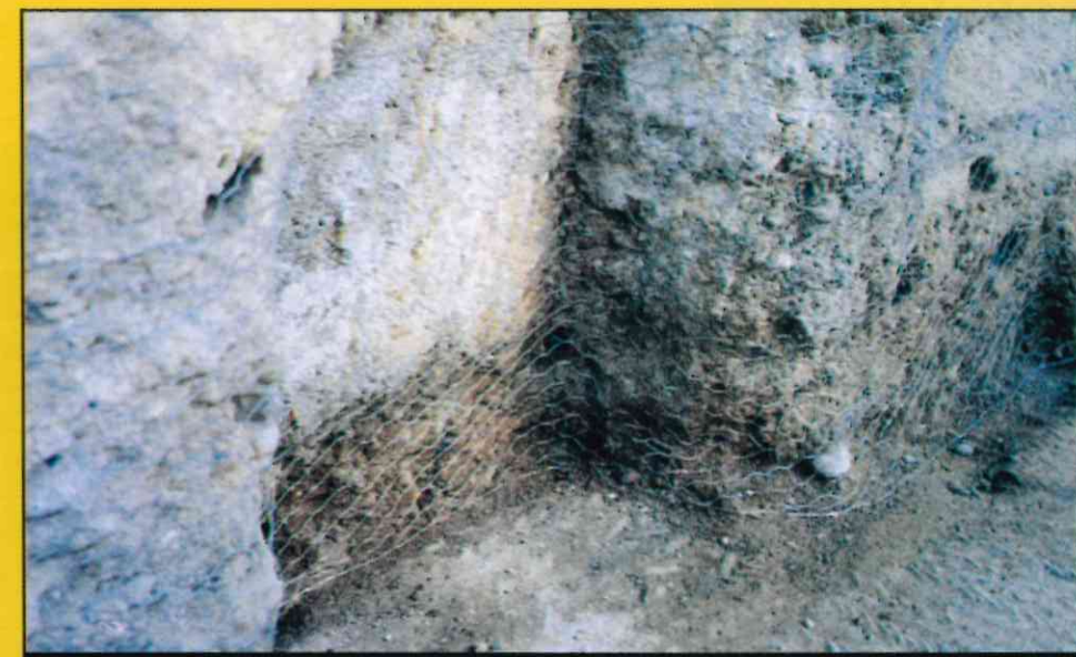
ARCO DE LAS PESAS. Tendido de mallas para favorecer la adherencia de los nuevos hormigones y revocados de cal.
