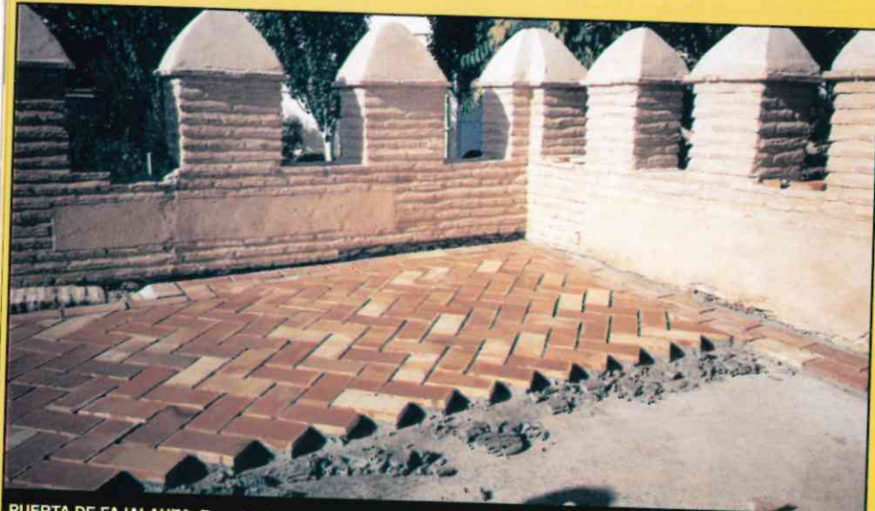
PUERTA DE FAJALAUZA. Remate de almenas de cubierta una vez intervenidas y ejecución del solado de cubierta.
