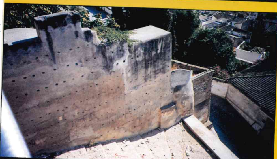
PUERTA MONAITA. Vista de las consolidaciones antiguas con mortero de cemento en la muralla árabe.
