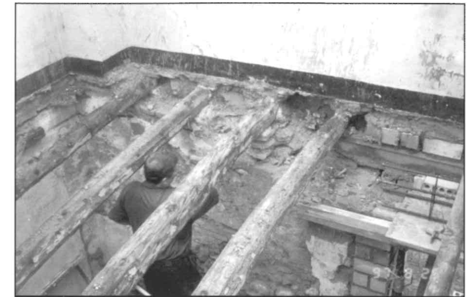
Picado de revestimiento en muros de carga de fachada para eliminación de mortero de cemento.
