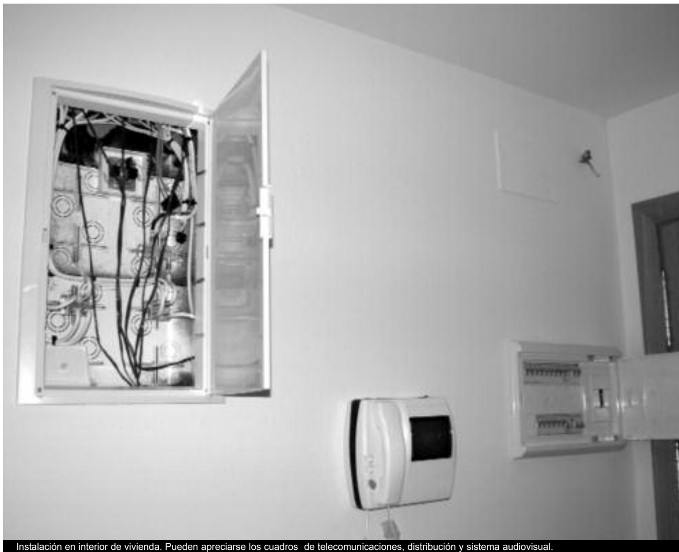
Instalación en interior de vivienda. Pueden apreciarse los cuadros de telecomunicaciones, distribución y sistema audiovisual.
