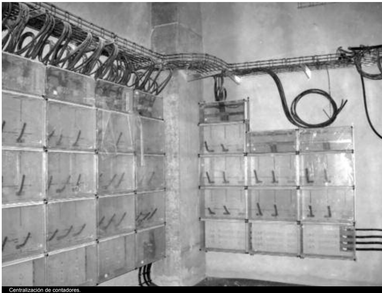
Centralización de contadores.
