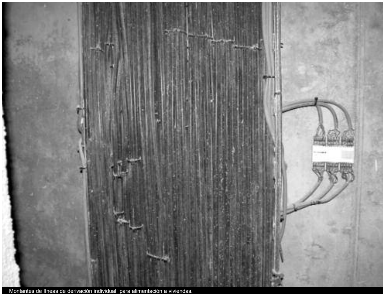
Montantes de líneas de derivación individual para alimentación a viviendas.
