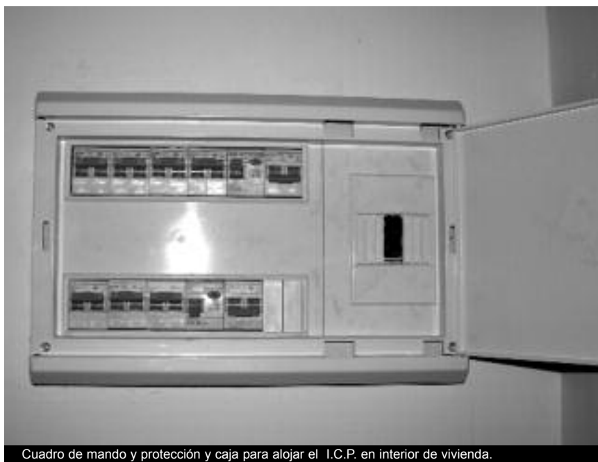
Cuadro de mando y protección y caja para alojar el I.C.P. en interior de vivienda.
