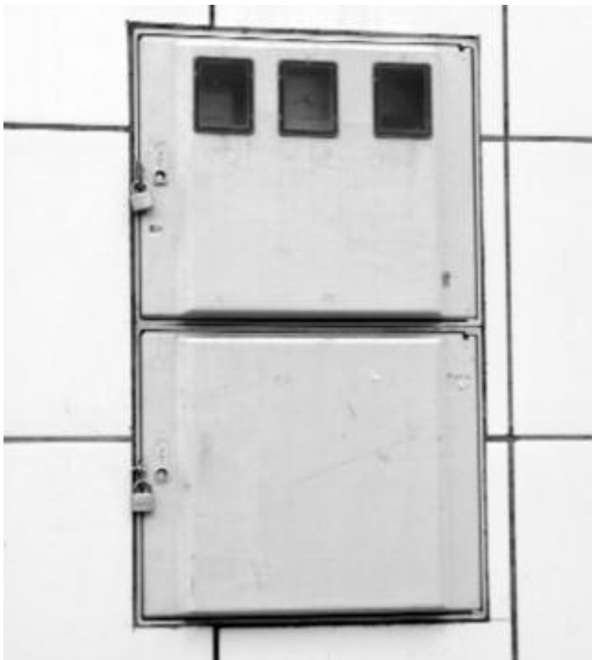
Caja general de protección, con módulo exterior colocado en fachada para sistema de medida con ventanilla de fácil lectura.
