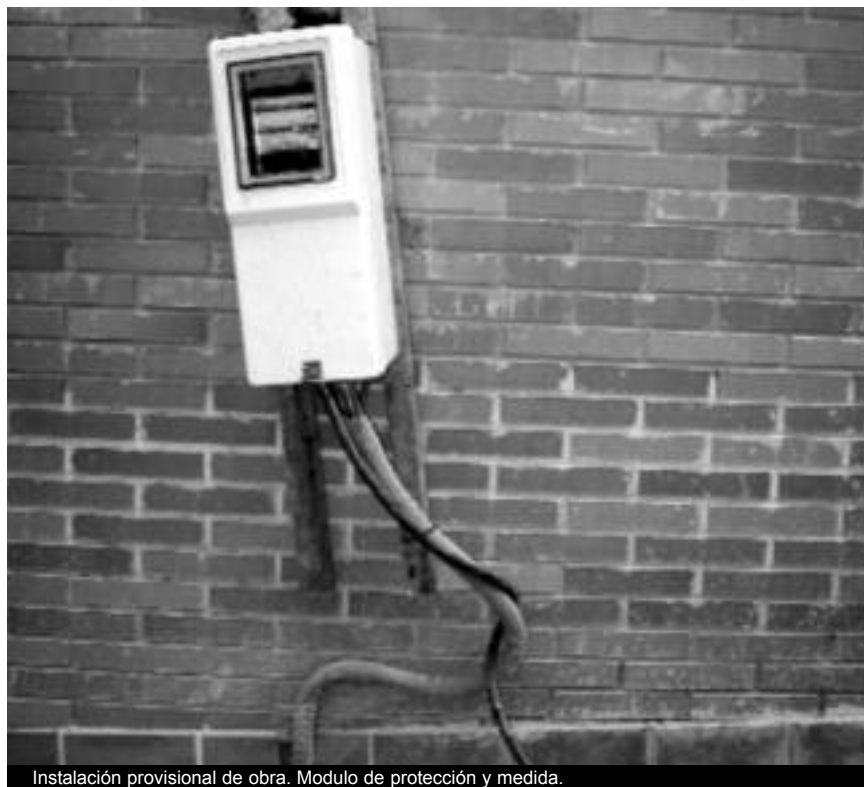
Instalación provisional de obra. Módulo de protección y medida.
