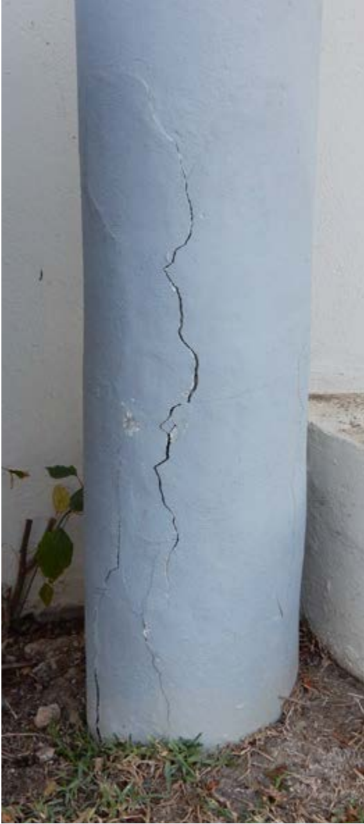
Ilustración 1. Soportes más afectados. De sección circular en planta baja. Color gris.
