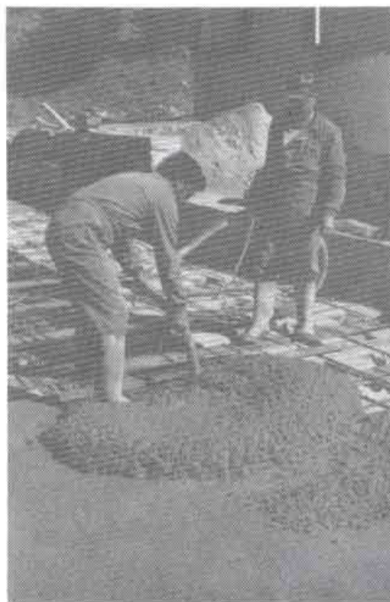
En gran número de ocasiones, cuando se construye una estructura sencilla de hormigón armado, se hace mal, aunque el elemento construido cumpla su función sin trauma aparente.
