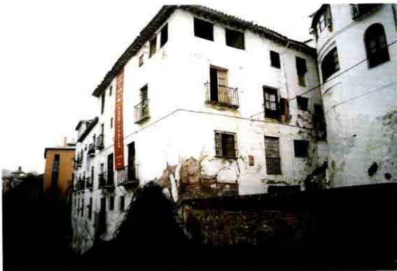
Estado en que se encontraba la "casa blanca" antes de su restauración.
