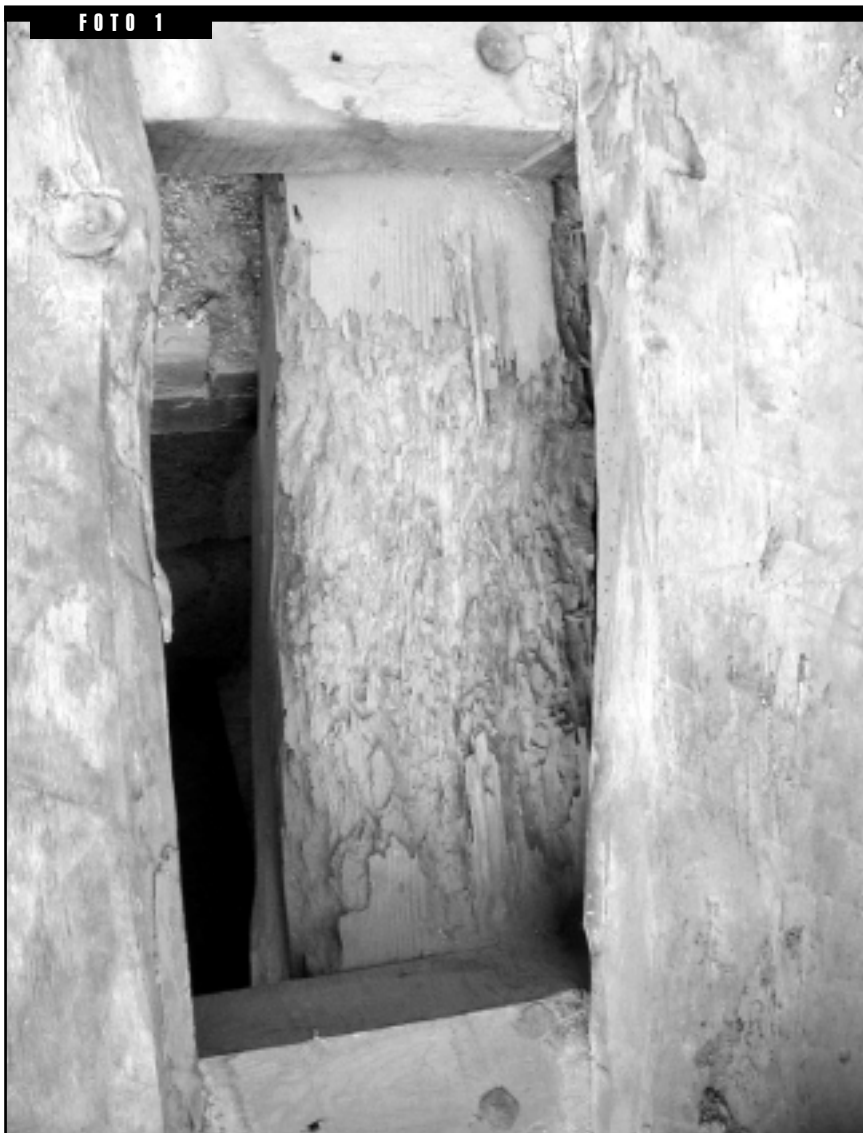
Presencia de termes en los pares de la cubierta del Pasaje Diego de Sílve.
