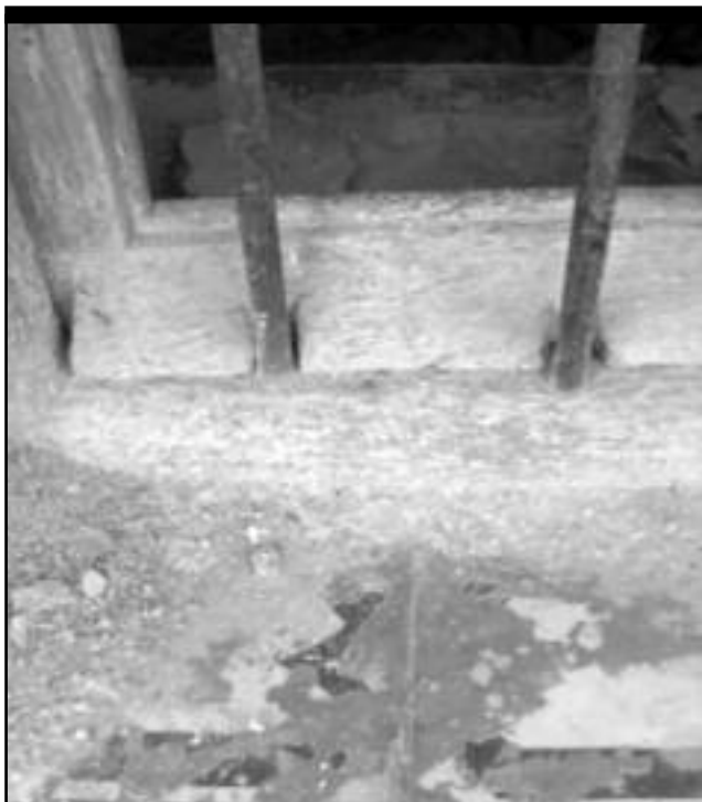
Anclaje a marco de reja carcelera.
