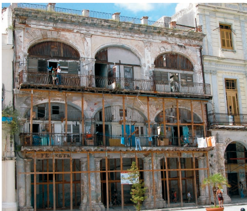
Edificio deteriorado. Uno más entre tantos.
